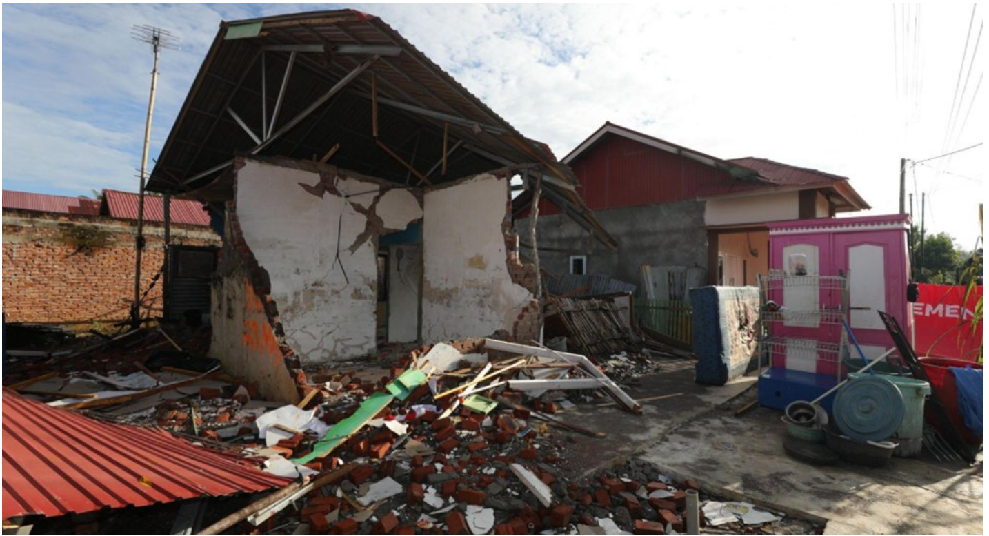
Gambar 24 Kondisi Rumah Rusak Akibat Gempabumi Bengkulu Sumber: BPBD Provinsi Bengkulu
