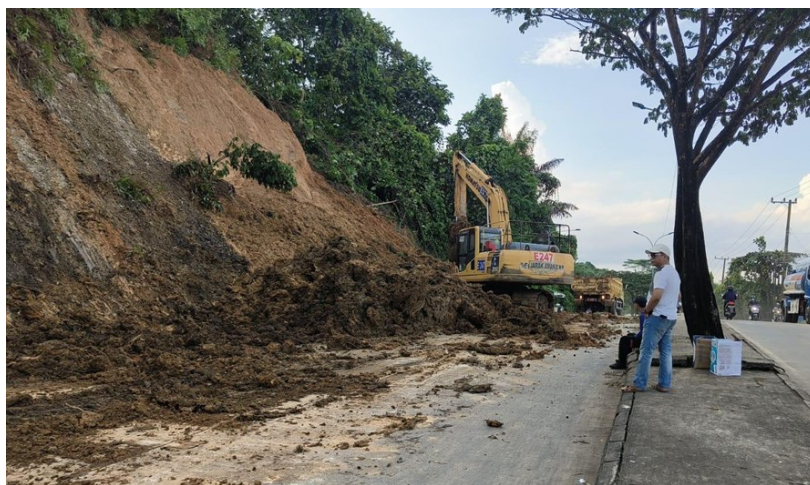
Gambar 14 Kondisi Tanah Longsor di Kelurahan Jawa Kecamatan Samarinda Ulu
